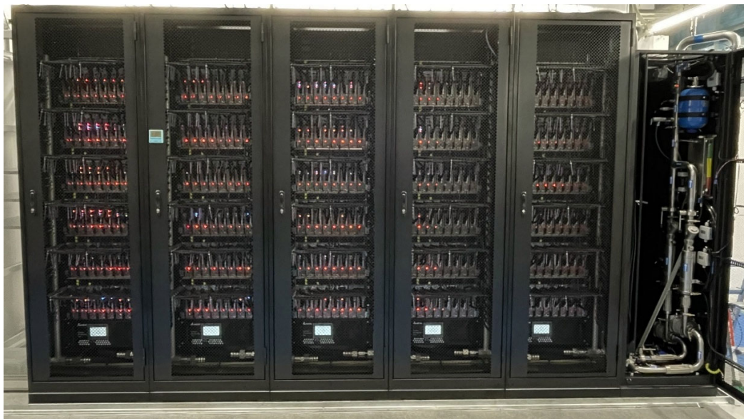
松江DCPに設置された直接水冷のMN-Core 2サーバ30ノードおよび水冷設備
